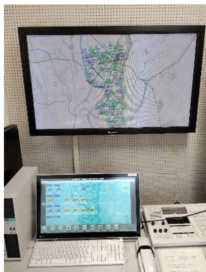
更新した防災行政無線 放送機器
