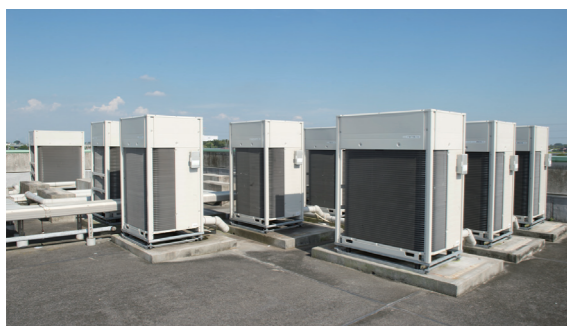
GHP式からEHP式へ入れ替えた空調設備
