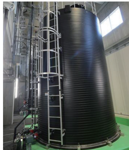
次亜塩素酸ナトリウム貯槽
