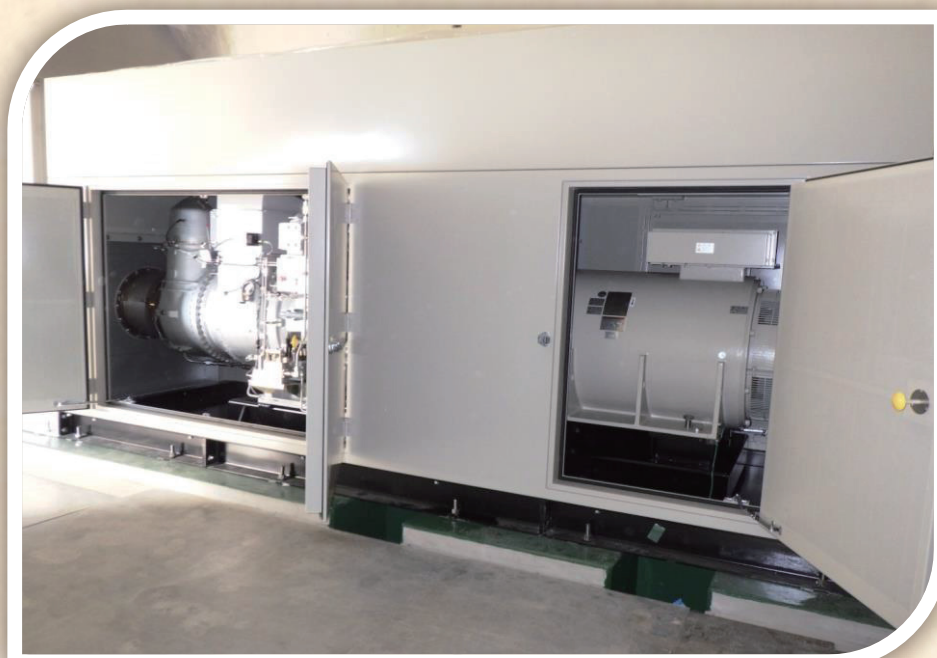
柿木浄水場 自家用発電機設備（草加市） エンジン（左）、発電機1200KW（右）
