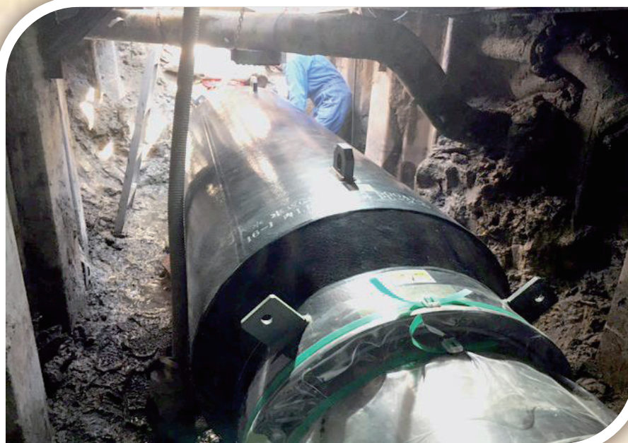
上馬場水管橋耐震補強工事（八潮市）平成27年度更新 【水管橋 地中部分の工事】
