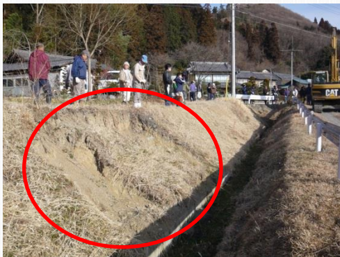
【水路法面の崩落状況】
