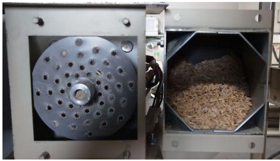
図4 バイオマス燃料供給装置 流量規制板
