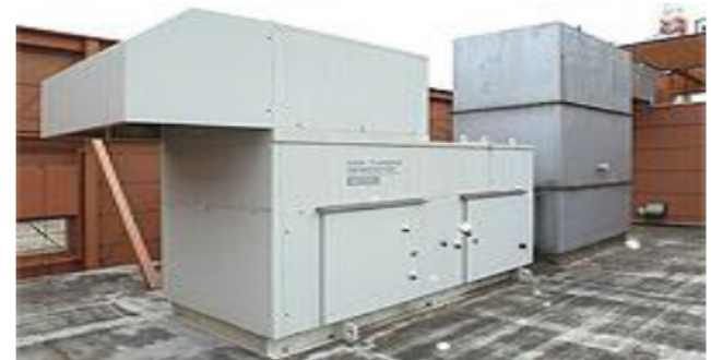
（非常用自家発電装置）
