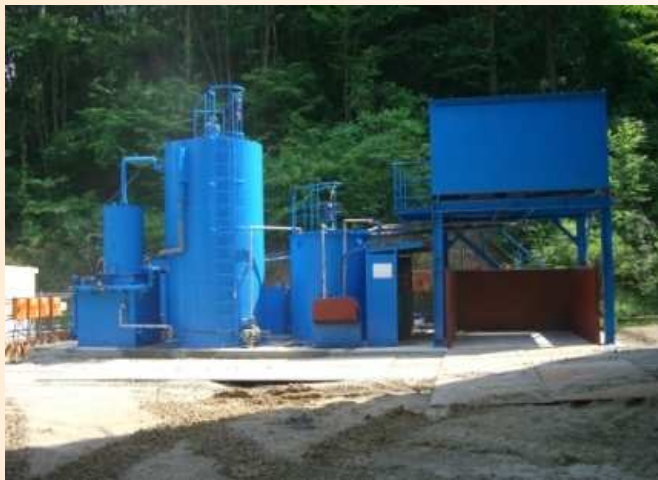
濁水処理設備 【トンネル施工時の濁水処理】
