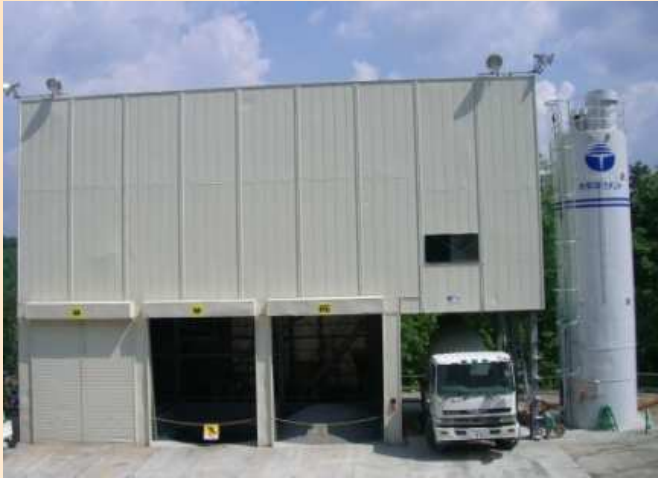
吹付プラント 【吹付コンクリート材の製造】
