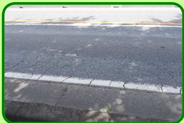
舗装の修繕前
