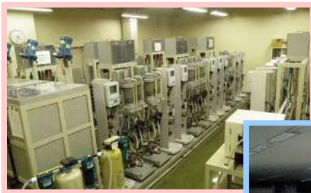
写真5：水質計器 （行田浄水場）
