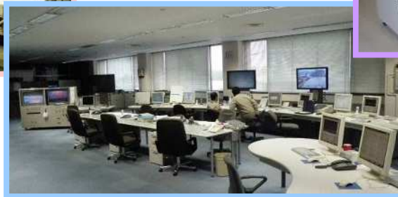
写真6：浄水場中央管理室 （行田浄水場）
