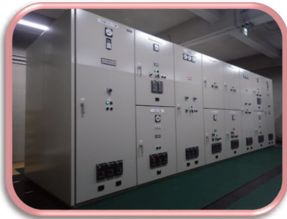
更新した電気設備
