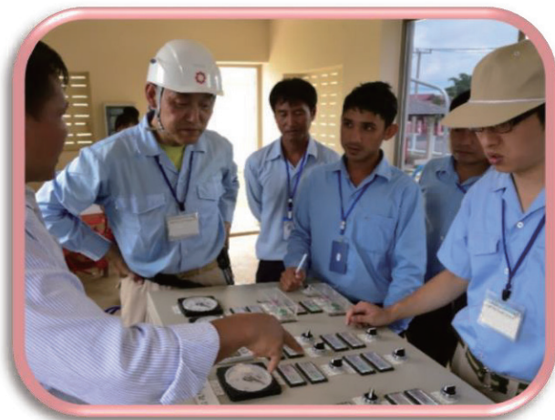
ろ過池操作盤操作指導（カムアン県にて）
