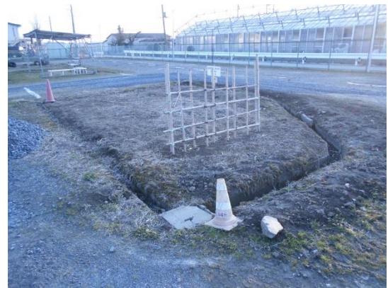
農薬洗浄水廃棄場所の設置
