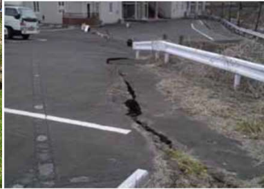
(b)のり肩の亀裂の事例
