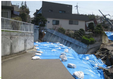
(c)腹付け盛土の崩壊の事例
