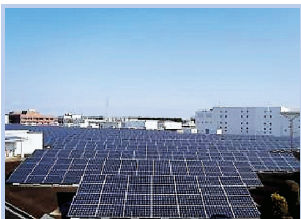
写真3-11-3 行田浄水場太陽光発電設備
