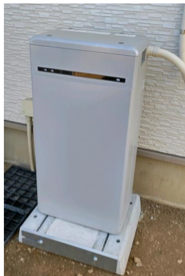
蓄電池（補助対象設備）
