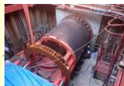
下水道施設の耐震
