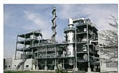
中川水循環センターにおける河川に放流する処理水の水质監視装置の設置、下水に流れ込むごみを除去する装置の設置など
