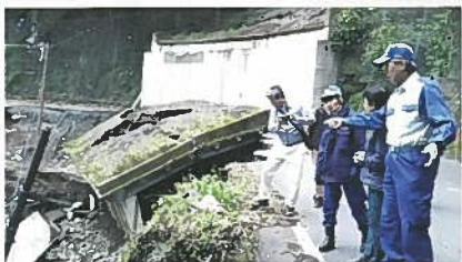
台風19号で崩落した秩父の県道210号線の現場に(2019年10月)
