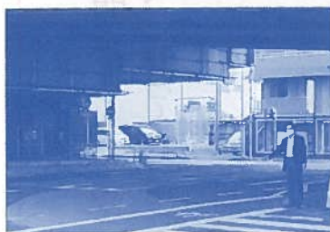
首都高速川口線下の本蓮二丁目交差点の右折表示工事が完了。「右折注意」がありながらレーン表示がなく、「危険だ」と、住民の方々から改善が要望されていました。
