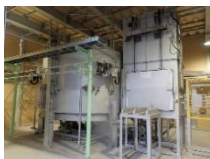
<Li-ion電池リサイクル設備>
