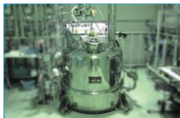
<バイオマスプラスチック製造設備>
