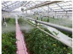
細霧冷房装置
