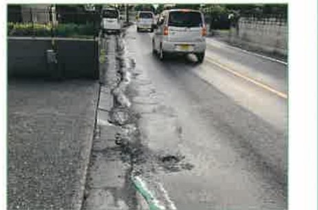
補修を繰り返している既存の県道
