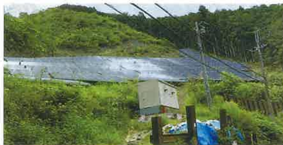
▲山間急傾斜地に設置された太陽光発電施設
