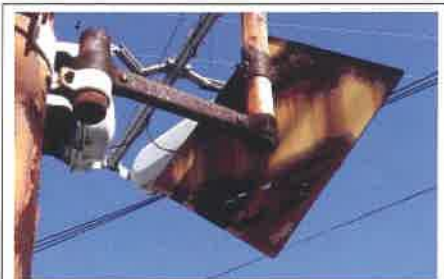
錆だらけの標識(浦和区・大原陸橋(東)交差点)
