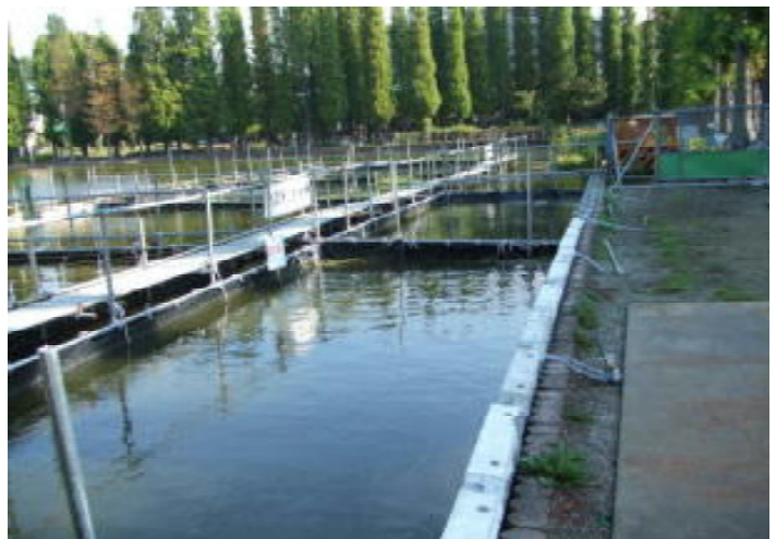
図11 別所沼における湖沼浄化技術実証試験施設
