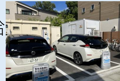
チャージエリア (蓄電池、EV、EV充放電器など)
