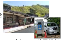
EV車等への給電設備
