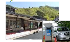
EV車等への給電設備
