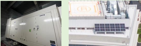
自家発電機 太陽光パネル
