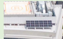
太陽光パネル
