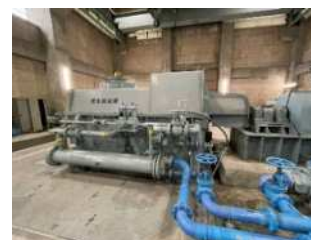
排水機場ポンプ設備 毛長川 (川口市)
