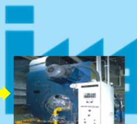
既設ボイラー
