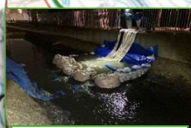
春日部中継Pからの 汚水の緊急放流
