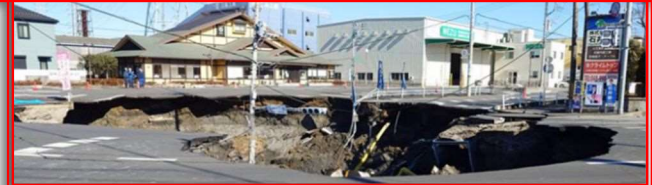
〔陥没箇所〕県道松戸草加線（中央一丁目交差点内） マンホール（チュウ4）
