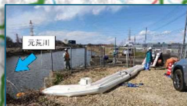
元荒川からの取水 を新方川へ放流
