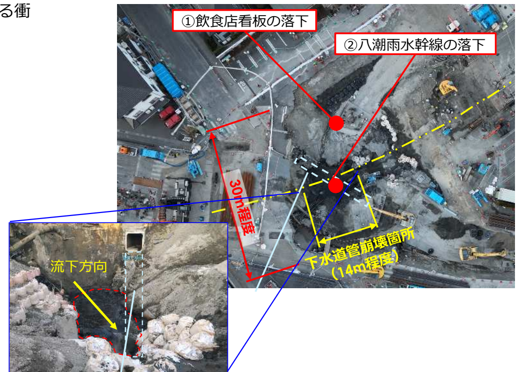
②八潮市雨水幹線の落下
