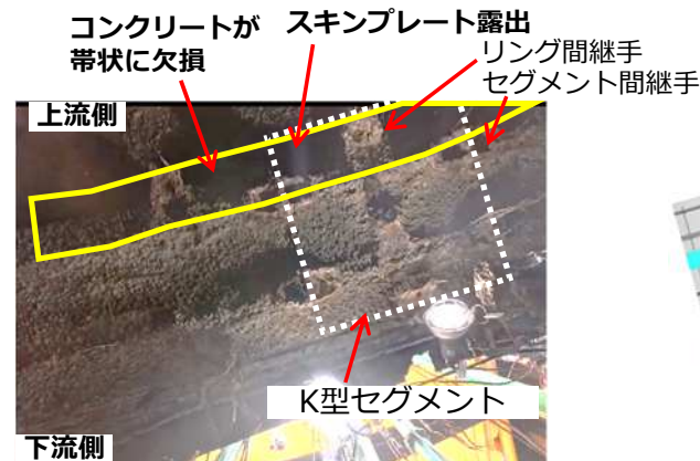
写真② シールドマシン残置部内のRCセグメント詳細 (事故後撮影)
