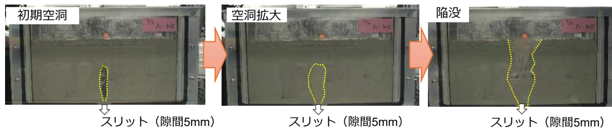
空洞の形成、陥没の状況（ケース1）
