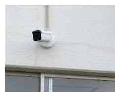
防犯カメラの設置
