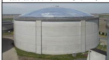
備蓄施設（P C浄水池）
