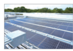
▲同センターの太陽光パネル
