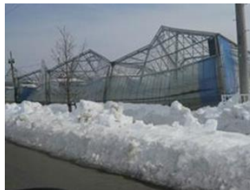
写真 2.2 農業用施設の被害状況
