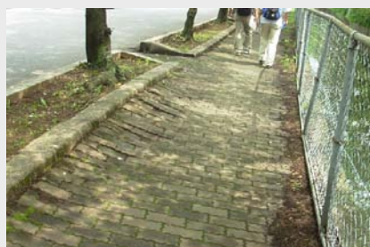
路面のゆがみ・段差
