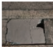
側溝蓋の破損
