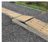
点字ブロックの剥離
