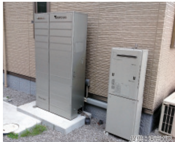
写真3-13-5 住宅に設置されたエネファーム
