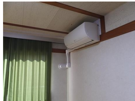
(寮室内のエアコン)
