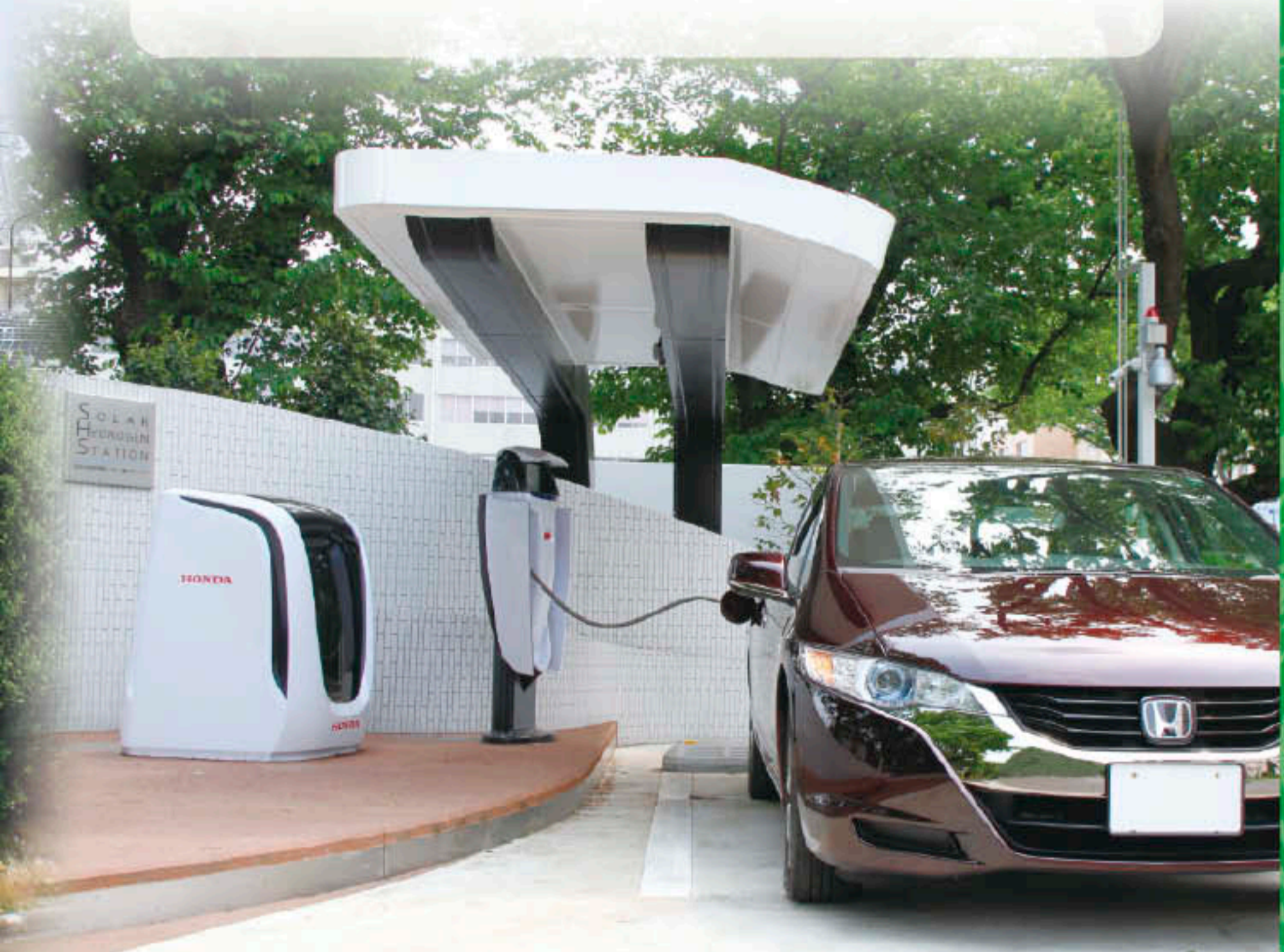
太陽光発電を活用して水素を製造する「次世代ソーラー水素ステーション」
